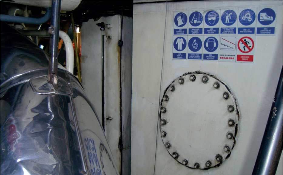
Cartelería en sala de máquinas
