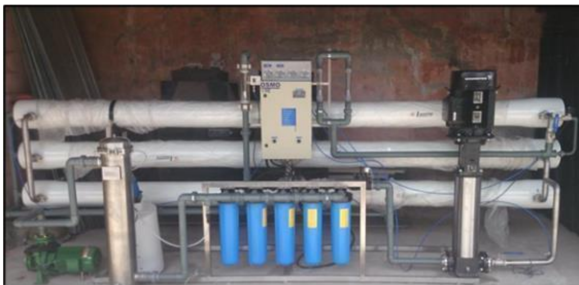
Figura 81: planta potabilizadora de ósmosis inversa.
