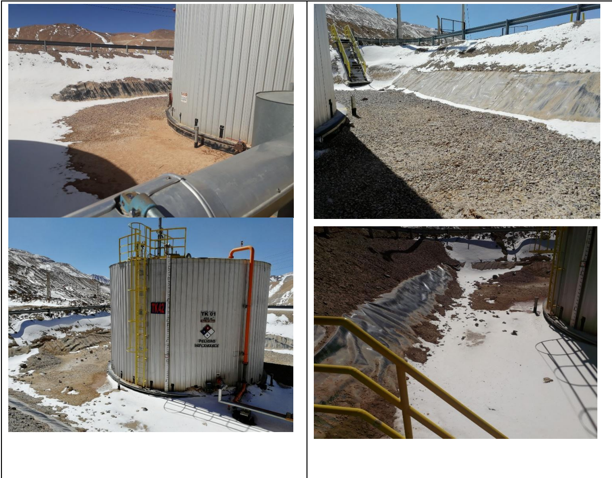
Figura 18: Vista de una batea de antiderrames con geotextil
